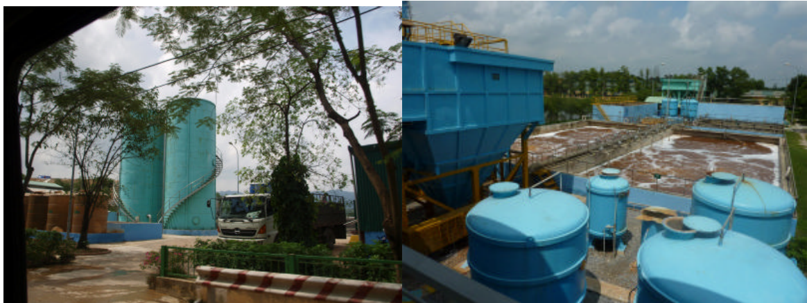
汚水処理施設
