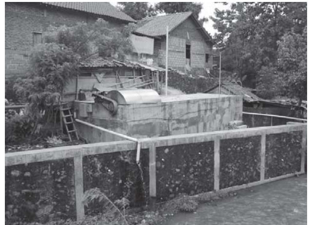
図4 嫌気性処理と好気性処理（回転円板）を組み合わせたコミュニティ排水処理設備
