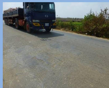
過積載車両の通行により 破損状況が深刻化
