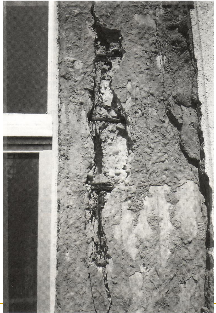
写真-4 センター柱のひび割れ
