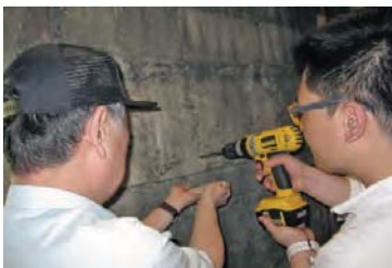
フィリピンにおける構造物の劣化調査
