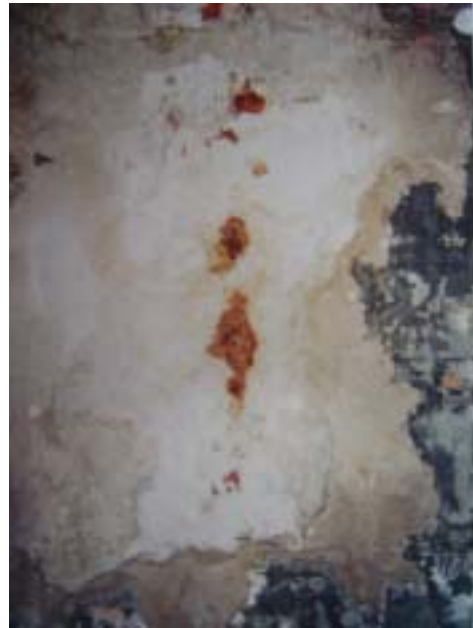
写真-12 壁に埋め込まれた鋼管の腐食(周辺モルタルが一部はつきり取られている)
