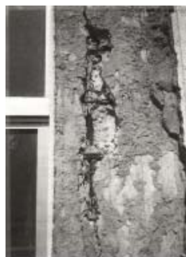
写真-4 センター柱のひび割れ
