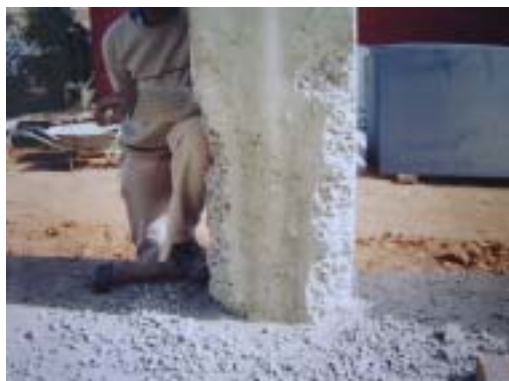
写真-22 柱下部のジャンカの除去
