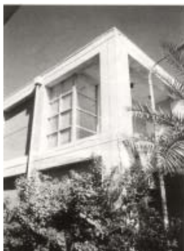
写真-3 センターの柱、梁のひび割れ
