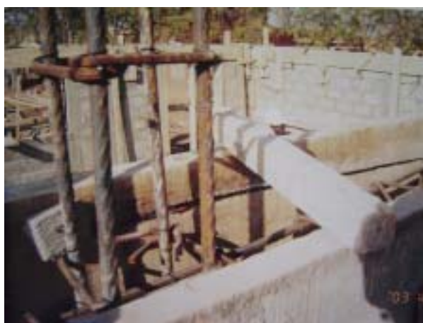
写真-18 割れた板材が使用されている型枠
