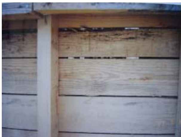
写真-19 隙間の空いた型枠
