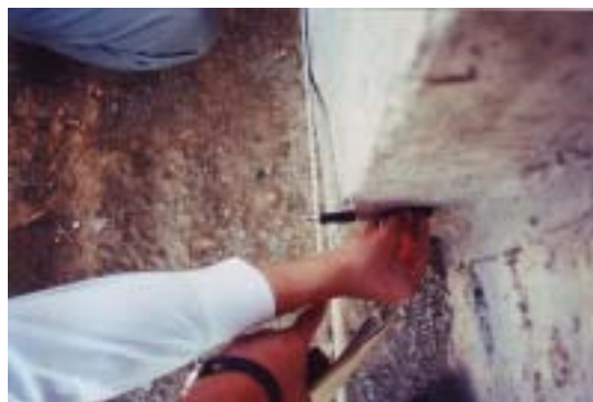
写真-25 はらんだ建屋の壁
